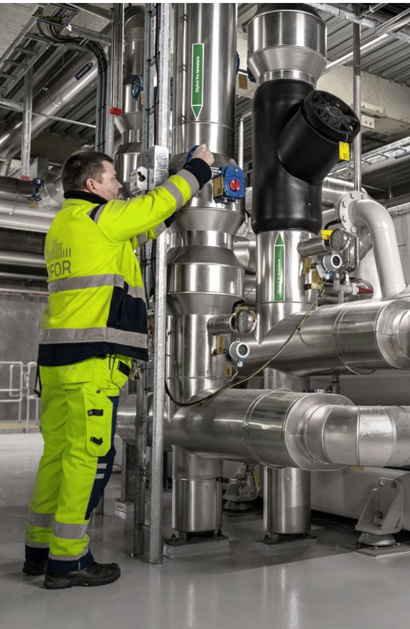
Fjernkølingsanlæg i Kranparken, København
