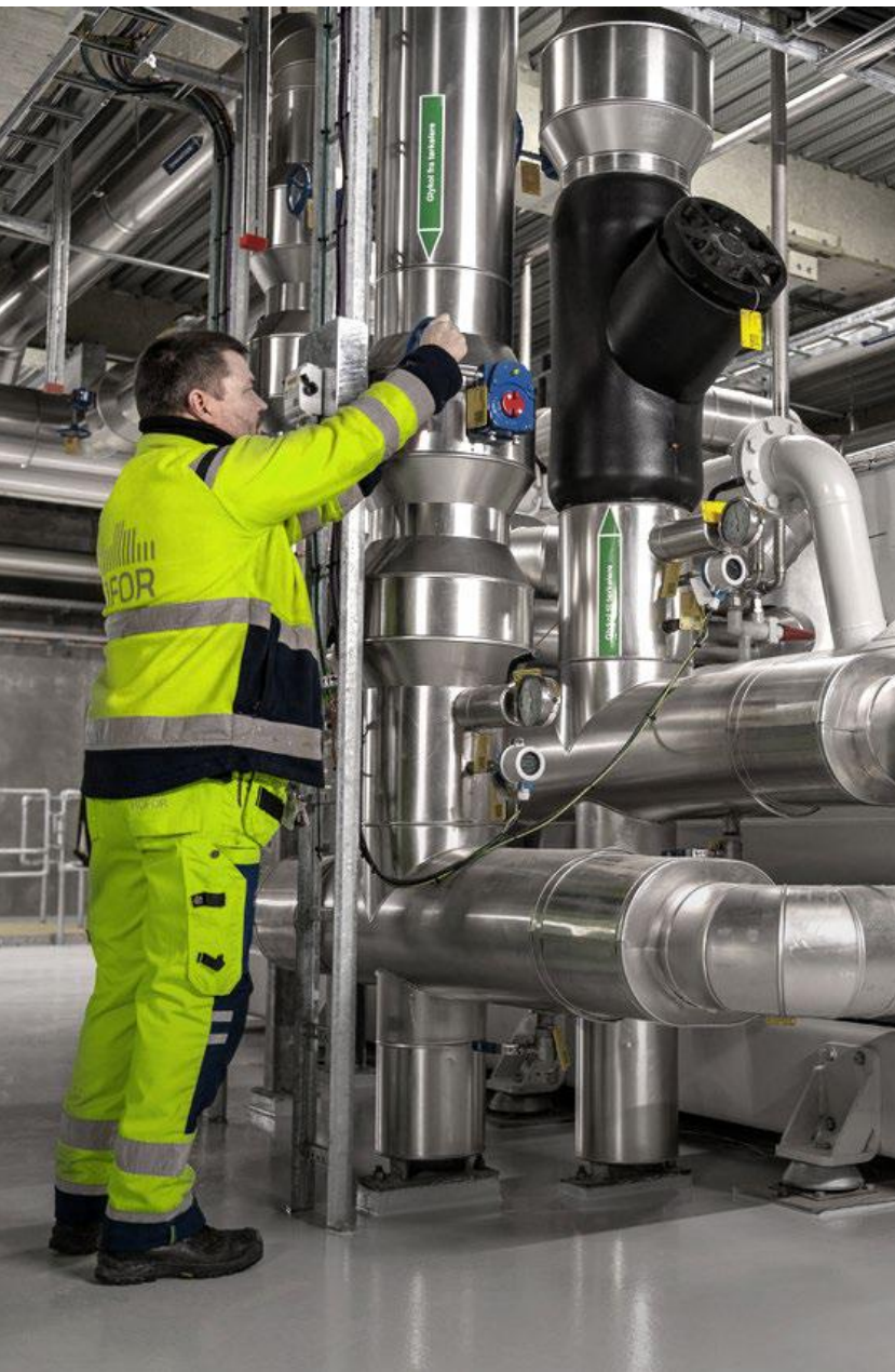
Fjernkølingsanlæg i Kranparken, København
