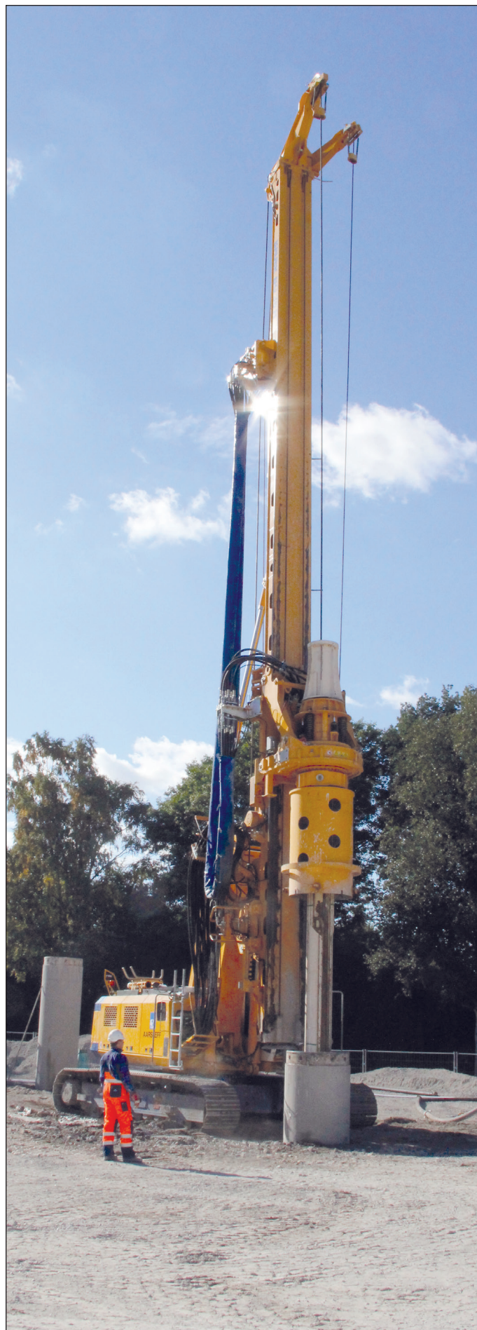
SEKANTPÆLE. Sekantpæle etableres med en stor boremaskine, som borer et dybt hul i jorden, der herefter fyldes med beton. Etablering af vægge til skakte er almindeligvis den mest støjende aktivitet i anlægsperioden.
